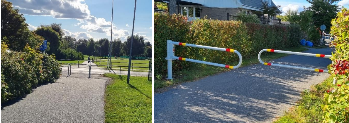
Figur 14. Exempel på hinder på gång- och cykelbanor som innebär nedsatt tillgänglighet och förhöjd olycksrisk för fotgängare och cyklister.
